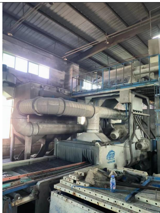
喷漆废气收集系统
