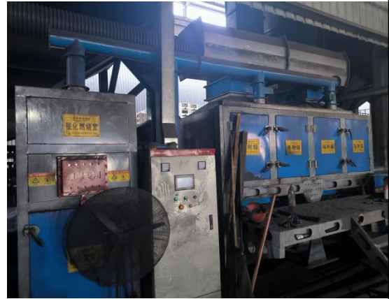
浇筑废气处理装置
