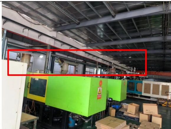
注塑机废气收集装置
