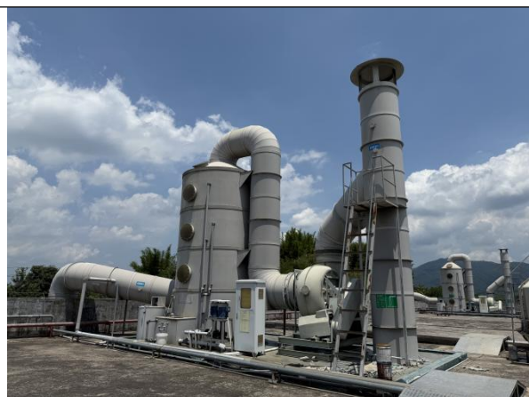
碱液喷淋塔 (DA007)
