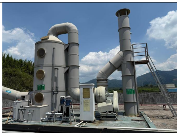
酸液喷淋塔 (DA008)
